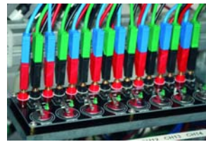
Das Dresdner Innovationszentrum zeigt die Technologie neuer Energiespeicher.
